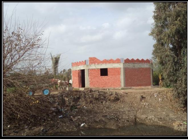
صورة (٥٤) توضح مبنى غير مكتمل البناء بجوار المجارى المائية بميت العز
