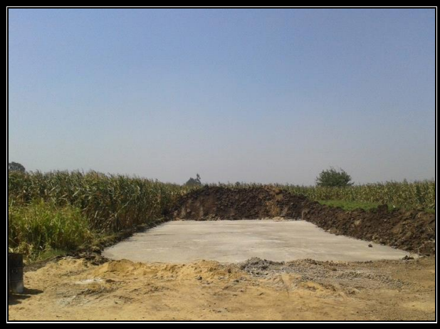
صورة (٢) توضح إحدى طرق التبوير المباشر بوضع طبقة الأسمنت تمهيداً للبناء بقرية أم خنان ٢٠١٣/٩/٢١
